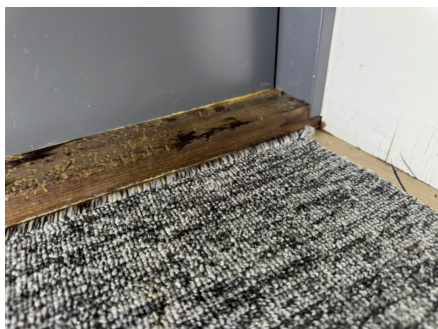
Døren tar i karmen ved åpning og lukking.
