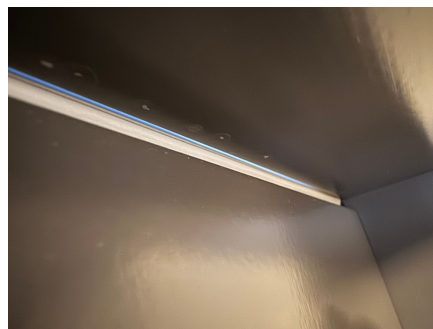
Åpning mellom karm og pakning.
