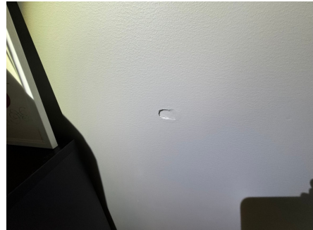
Skade i vegg etter håndtak på dør.
