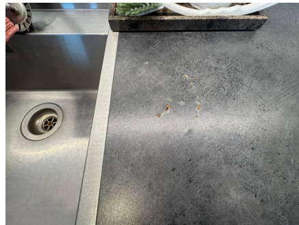
Skade på benkeplaten.
