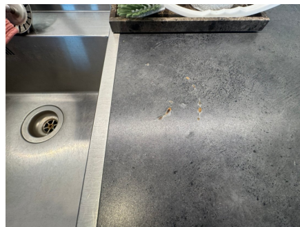
Skade på benkeplaten.
