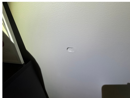
Skade i vegg etter håndtak på dør.
