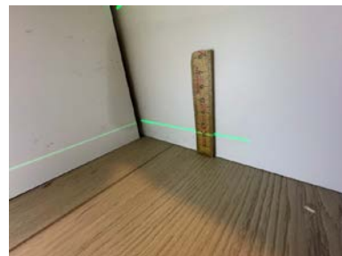
Måling ved kjøkkenet.
