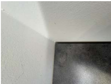
Det er ikke fuget mellom benkeplaten og veggen.
