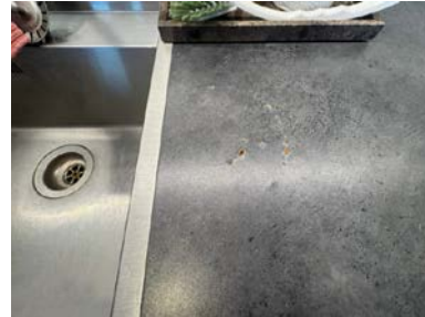
Skade på benkeplaten.
