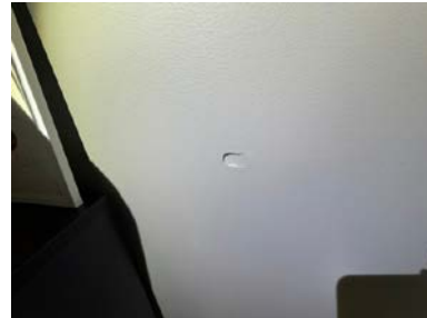
Skade i vegg etter håndtak på dør.
