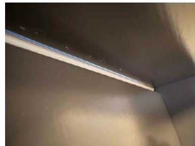
Åpning mellom karm og pakning.
