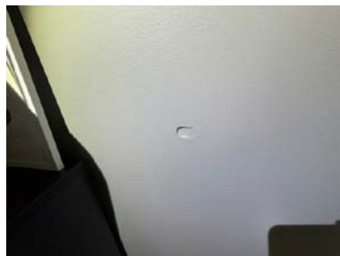
Skade i vegg etter håndtak på dør.
