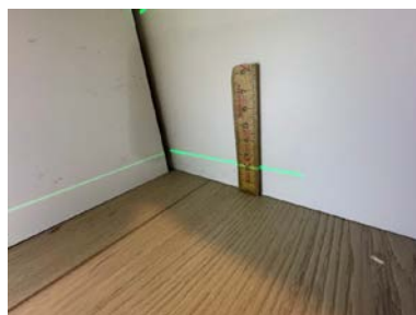
Måling ved kjøkkenet.
