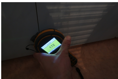
Fuktsøk i nedre del av våtromsplater
