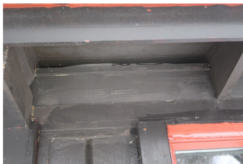
Manglende netting i luftespalte
