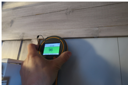
Fuktsøk i øvre del av våtromsplater
