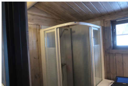
Bilde viser uegnet materiale i dusjens våtsone
