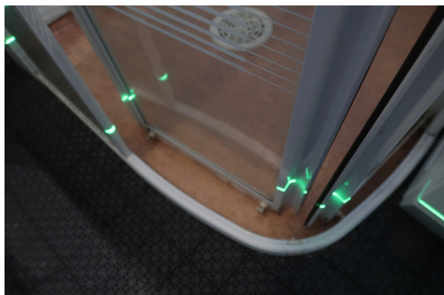
Bilde viser skade på glideskinner til dusjkabinett
