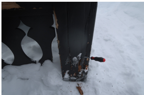
Råteskade i rekkverk søyle
