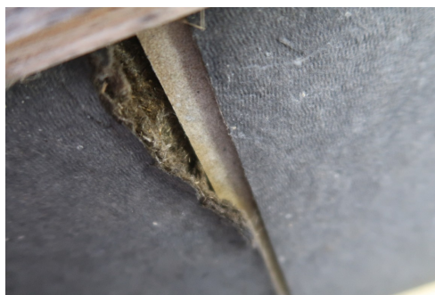
Bilde viser eksempel på skadet plate under bjelkelaget.
