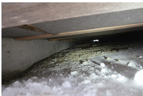
Bilde viser lav høyde i krypkjeller
