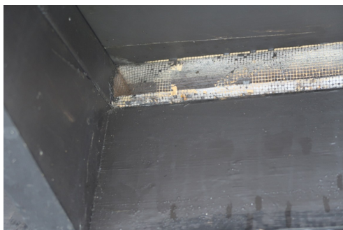
Skade på netting i luftespalte
