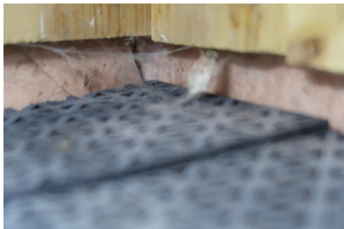
Bilde viser eksempel på sprekke-dannelse i gulvbelegget
