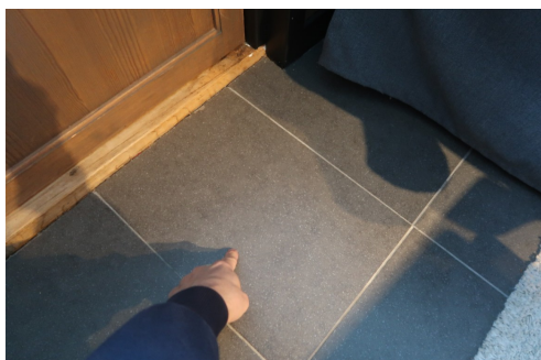
Bilde viser flis med bom/ hulrom under seg
