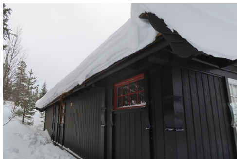
Manglende takrenner og nedløpsrør
