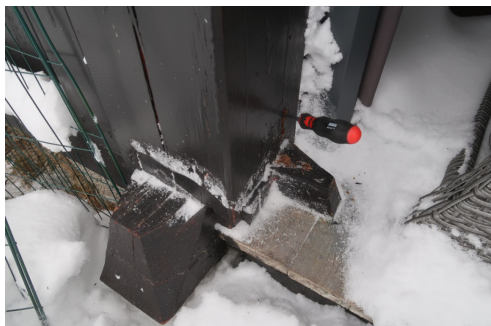
Råteskade i søyle mot nordvest
