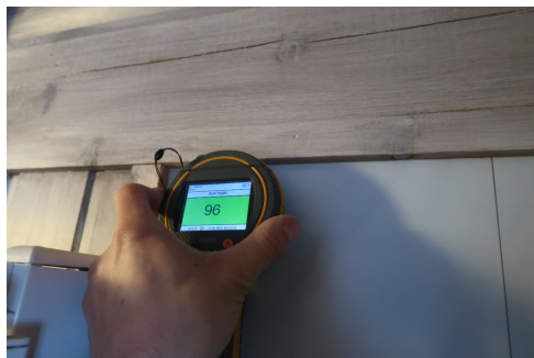
Fuktsøk i øvre del av våtromsplater
