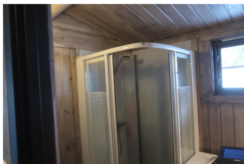
Bilde viser uegnet materiale i dusjens våtsone
