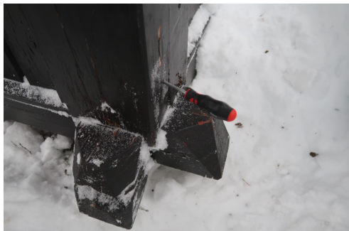
Råteskade i søyle mot sørøst
