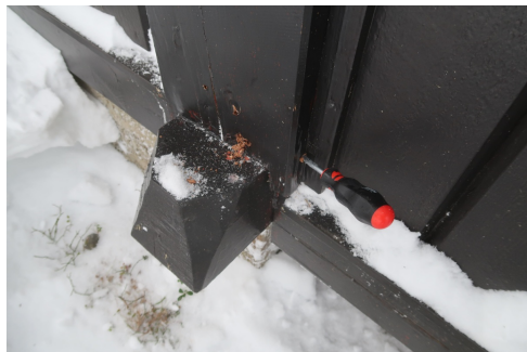
Råteskade i søyle mot øst ved tilbygg
