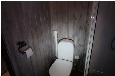
Bilde viser plassering av vakuumentil for lufting av avløp
