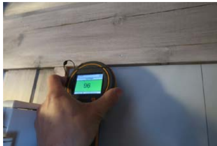
Fuktsøk i øvre del av våtromsplater
