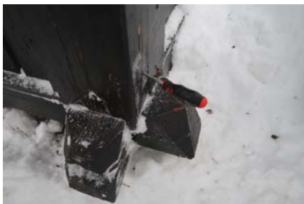
Råteskade i søyle mot sørøst
