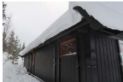
Manglende takrenner og nedløpsrør
