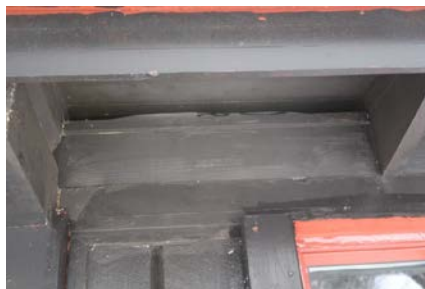
Manglende netting i luftespalte
