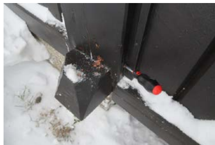
Råteskade i søyle mot øst ved tilbygg
