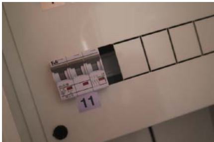
Bilde viser manglende deksel ved sikring
