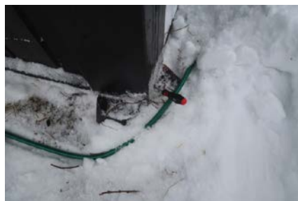
Råteskade i søyle mot sørvest. Liten avstand mellom yttervegg og terreng
