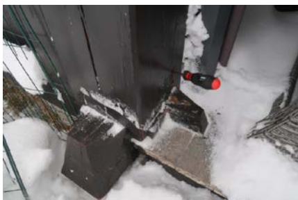
Råteskade i søyle mot nordvest
