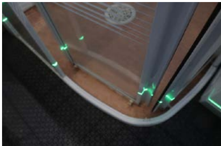
Bilde viser skade på glideskinner til dusjkabinett
