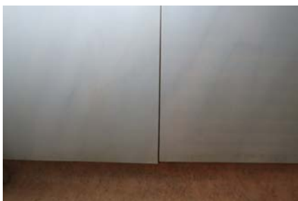
Bilde viser sprekk mellom baderomsplater
