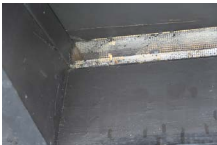
Skade på netting i luftespalte
