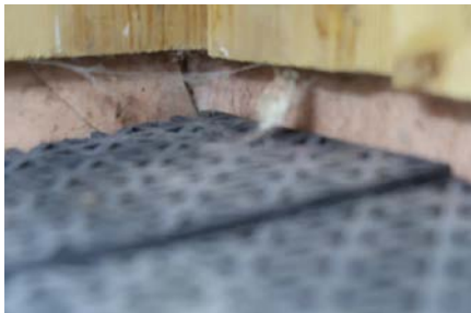
Bilde viser eksempel på sprekke-dannelse i gulvbelegget
