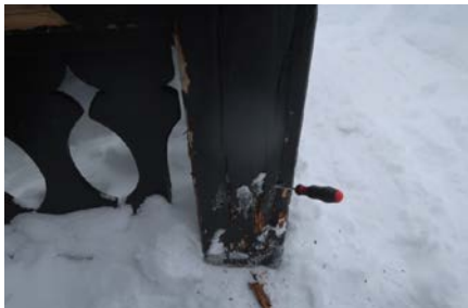
Råteskade i rekkverk søyle
