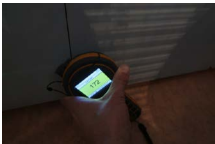
Fuktsøk i nedre del av våtromsplater
