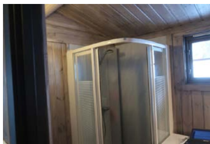
Bilde viser uegnet materiale i dusjens våtsone
