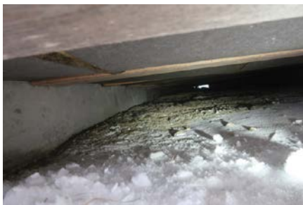
Bilde viser lav høyde i krypkjeller
