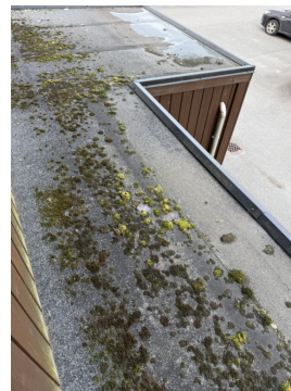
Grønske/mose i tak over inngangsparti og bod
