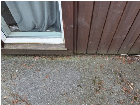
Slitt vannbord under vindu, noe lite luftning mellom terreng og utv. kledning
