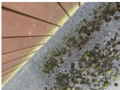
Grønske i kledning ved tak over inngangspart
