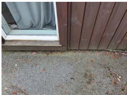
Slitt vannbord under vindu, noe lite luftning mellom terreng og utv. kledning
