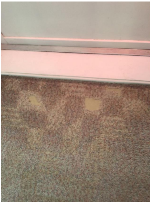
Teppe på soverom har slitasje.
