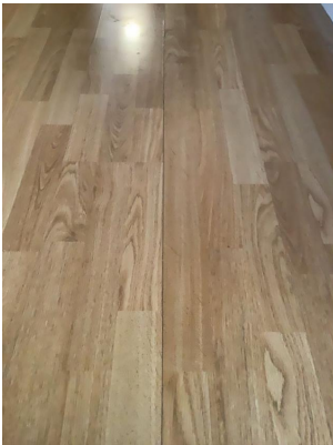
Sprekk i laminatgulv på kjøkken i underetasjen.
