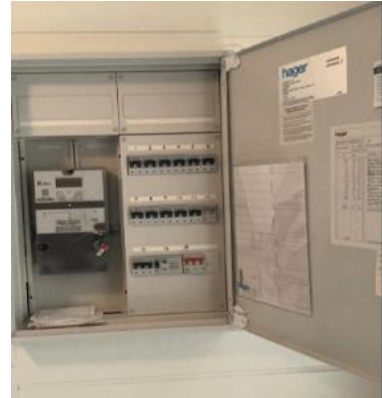
Sikringskap plassert i bod i hovedenhet.
