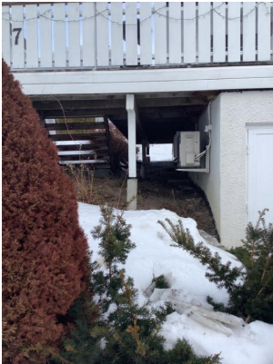
Skjevheter i fundamenter under terrasse mot vest.
