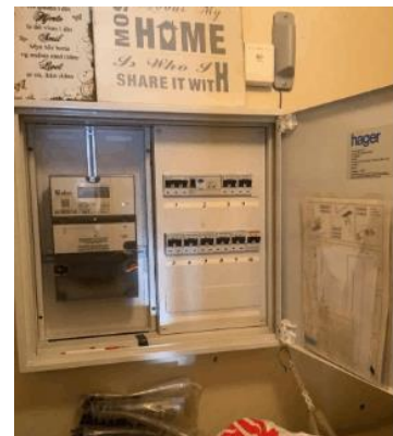
Sikringskap plassert i bod i leilighet.
