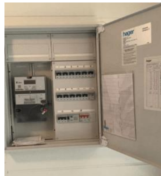
Sikringsskap plassert i bod i hovedenhet.
