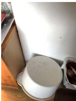
Enkelte riss/sprekker i pipe.
