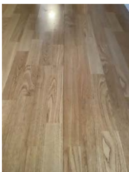
Sprekk i laminatgulv på kjøkken i underetasjen.
