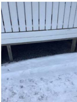
Tresøyler som står nede i terrenget er en dårlig løsning.
