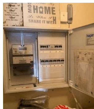
Sikringsskap plassert i bod i leilighet.
