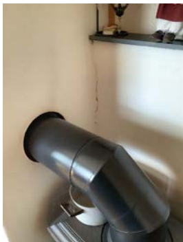
Enkelte riss/sprekker i overgang pipe/brannmur.
