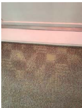
Teppe på soverom har slitasje.
