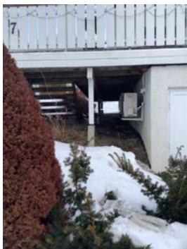
Skjevheter i fundamenter under terrasse mot vest.
