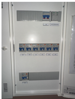
Sikringsskap med automatsikringer.
