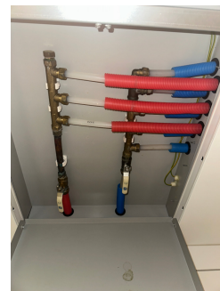
Samleskap på bad med stoppekraner
