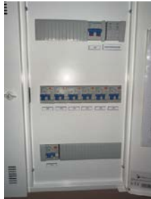
Sikringsskap med automatsikringer.
