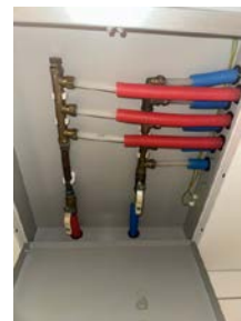
Samleskap på bad med stoppekraner
