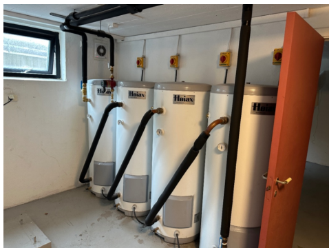
Varmtvanns beredere i kjelleren
