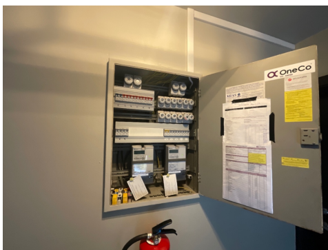
Sikringsskap i trappegang
