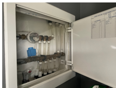
Rør i rør skap i garderobe på kjøkken
