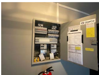
Sikringsskap i trappegang
