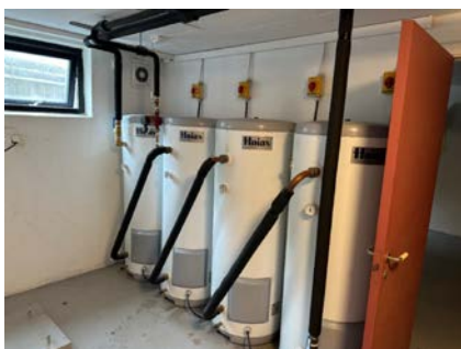
Varmtvanns beredere i kjelleren
