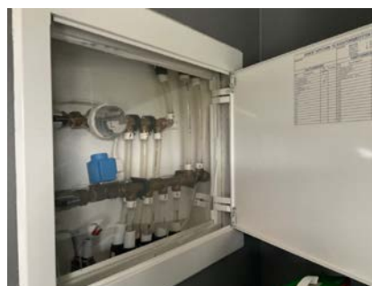
Rør i rør skap i garderobe på kjøkken
