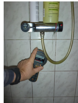
Viser fuktsøk hvor det ble registrert høye verdier av fukt bak veggfliser i dusj
