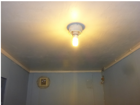
Viser taklampe som mangler kuppel.
