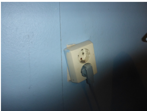
Viser løs kontakt i vaskerom.
