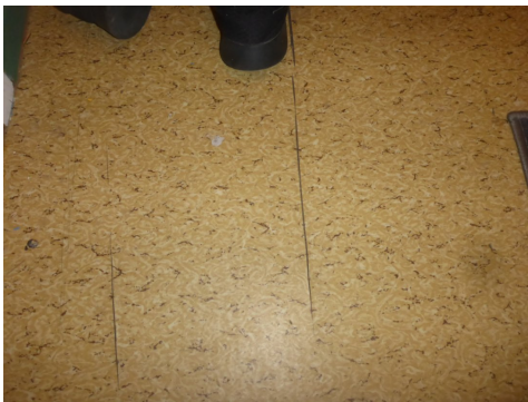
Viser skader på gulv i vindfang.
