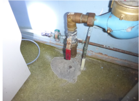
Viser skade på gulvbelegg.
