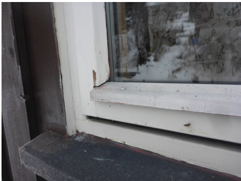
Viser vindu med utvendig værslitasje.
