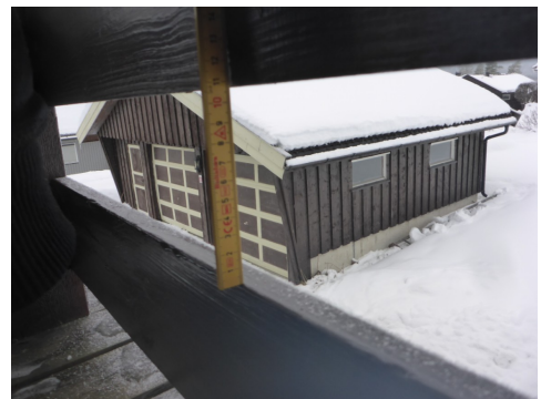
Viser veranda med for stor åpning mellom rekkverksbord.
