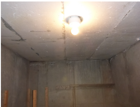
Viser utildekket isopor i himling utvendig bod.
