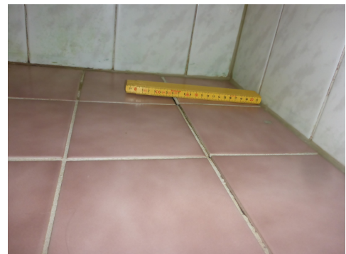
Viser løse fliser på gulv i dusj.
