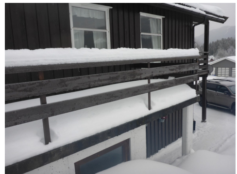
Viser takterrasse med for stor åpning mellom rekkverksbord og dekke.
