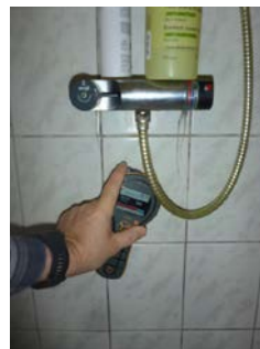
Viser fuktsøk hvor det ble registrert høye verdier av fukt bak veggfliser i dusj
