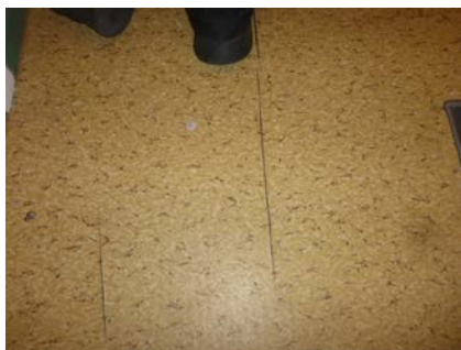
Viser skader på gulv i vindfang.
