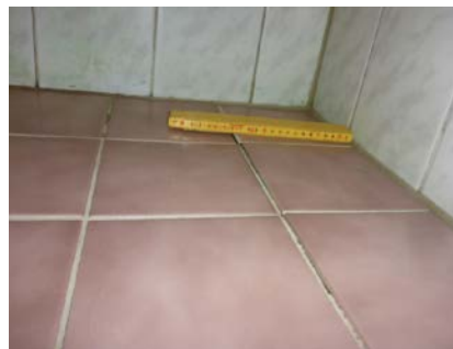
Viser løse fliser på gulv i dusj.
