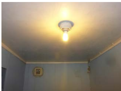
Viser taklampe som mangler kuppel.
