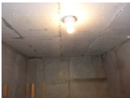
Viser utildekket isopor i himling utvendig bod.
