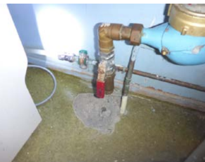
Viser skade på gulvbelegg.
