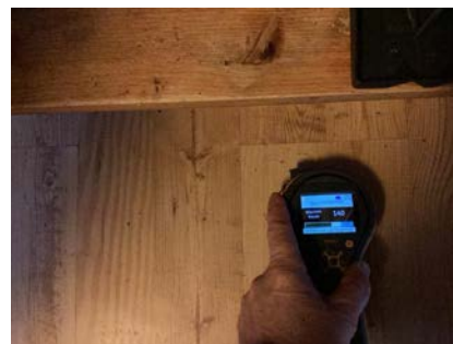
Viser fuktøk foran benkeskap uten å avdekke unormale verdier av fukt.
