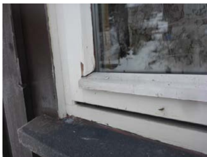
Viser vindu med utvendig værslitasje.
