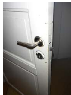
Viser slitasje og manglende håndtak på dør/vrider.
