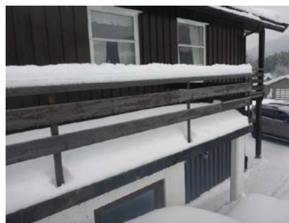
Viser takterrasse med for stor åpning mellom rekkverksbord og dekke.
