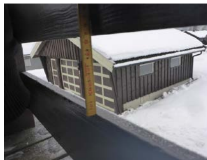
Viser veranda med for stor åpning mellom rekkverksbord.
