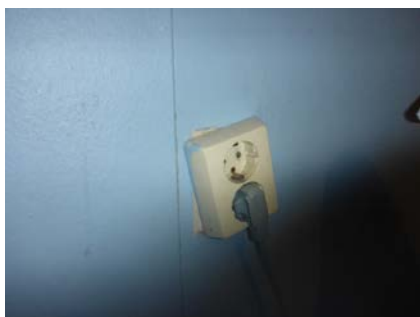
Viser løs kontakt i vaskerom.
