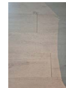
Glipe i kortskjøt på laminatgulv i stue.
