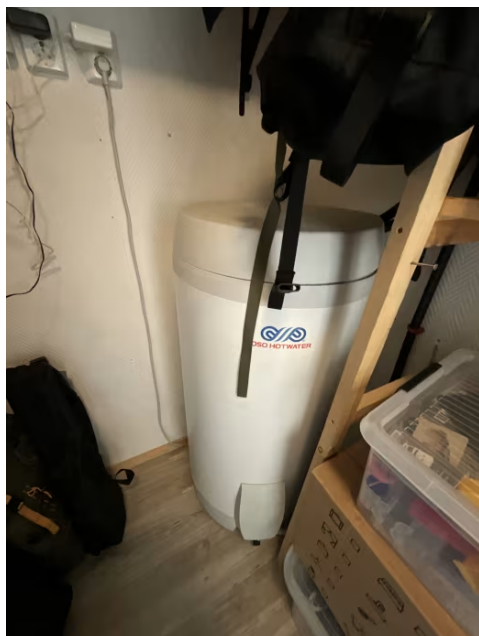
Viser varmtvannsbereder plassert i bod.
