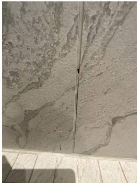
Det registreres sprekk i flisfuge i dusjsonen.
