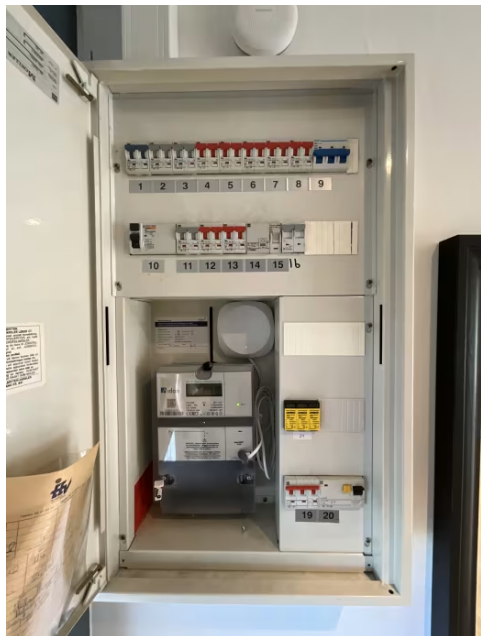
Viser innfelt sikringskap plassert i gang.
