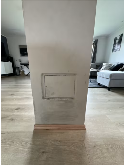
Viser sotluke plassert i stue.
