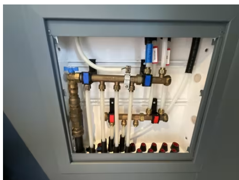
Vannrør med rør i rør system fra fordelerskap plassert i gang og frem til sanitærinstallasjoner på badetrom og kjøkken.
