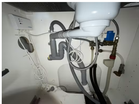
Viser vann og avløpsinstallasjoner under kum. Skjøteledning anbefales fjernet.
