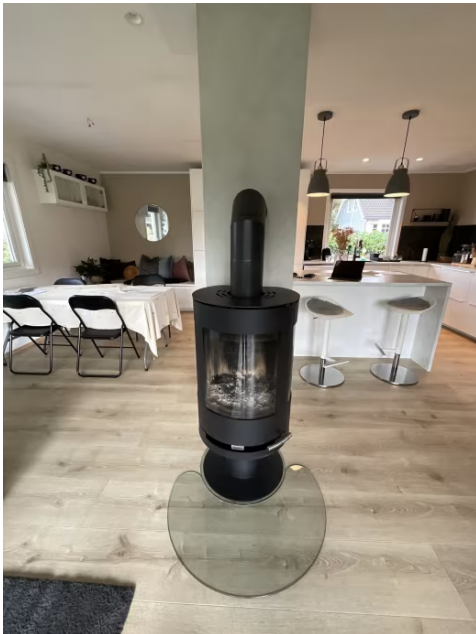
Viser ildsted montert i stue.
