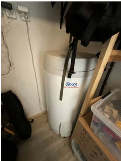
Viser varmtvannsbereder plassert i bod.
