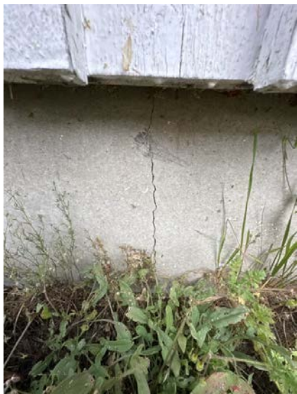
Det registreres mindre sprekker i grunnmursplater.
