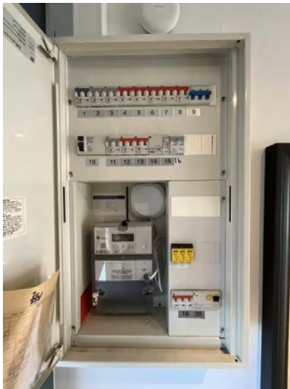
Viser innfelt sikringskap plassert i gang.
