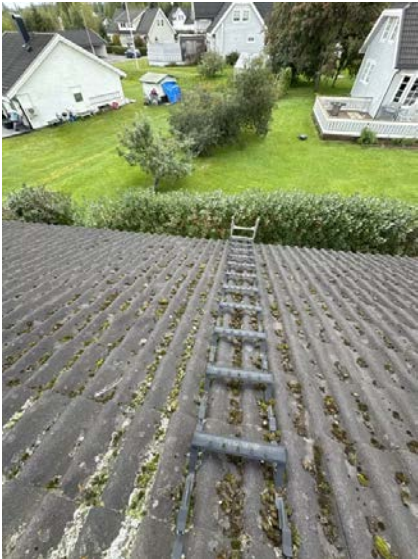
Taktekkingen har mose og slitasje på grunn av elde.
