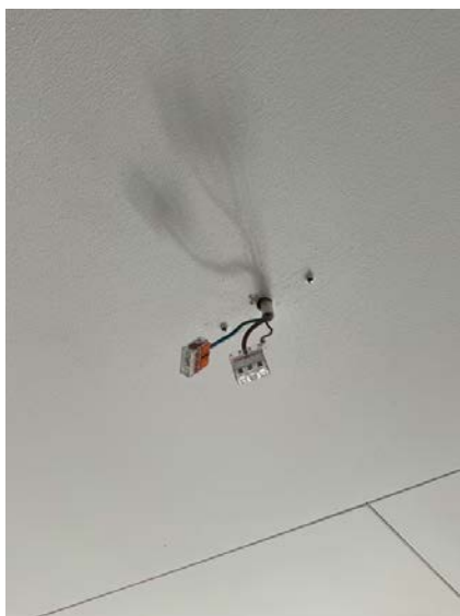
Viser kabel over spisebord. Kabel er ikke avsluttet forskriftsmessig.
