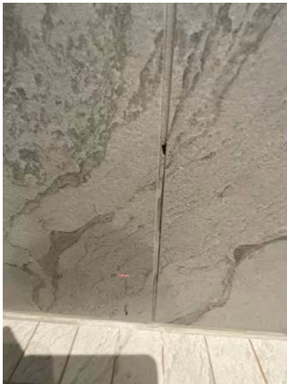
Det registreres sprekke i flisfuge i dusjsonen.
