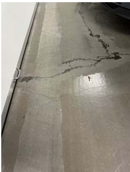
Det registreres sprekker i gulv. Anbefaler ytterligere undersøkelser.
