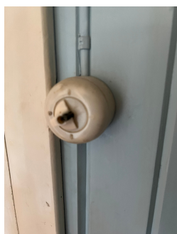
Kjøkken 2. Etg: Skadet lysbryter.
