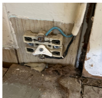
Stue 1. Etg: Defekt stikkontakt.
