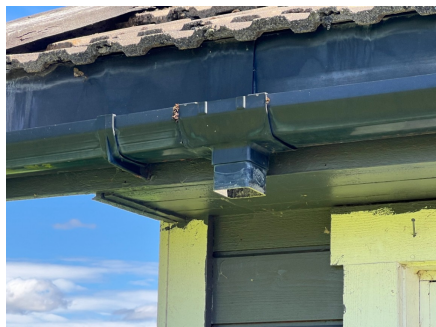
Takrenne uten nedløp.
