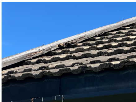
Råteskader i vindski- isbord- fremside- venstre side.
