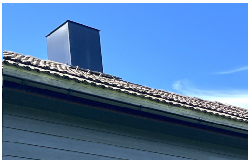
Bakside- Ikke forkantbeslag mellom tak/takrenne
