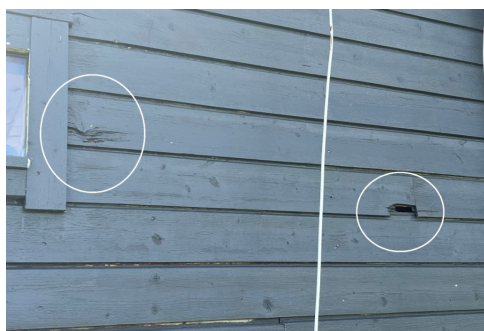
Råte og hull i kledning- (Innglasset terrasse)
