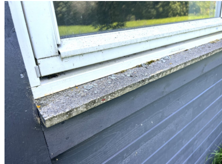
Vannbrett uten beslag og groing.
