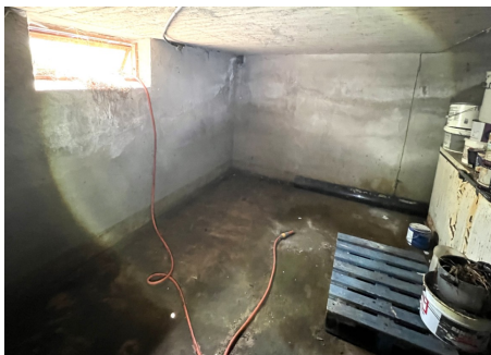
Nyere del av kjeller: Fukt og saltutslag.
