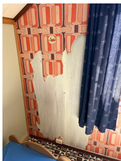
2. Etg: Soverom Skadet/løs tapet.
