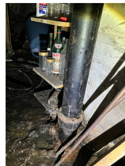
Soil hovedavløpsrør. Korrosjon. En del slam/vann/fukt.
