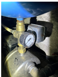
Overgang trykktank (blå) og vannpumpe under.
