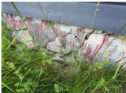
Utvendig: Sprekker i mur.
