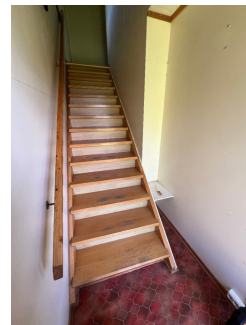
Ikke rekkverk i nedre del- høyre side.
