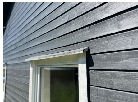
Vannbrett over vinduer uten beslag.
