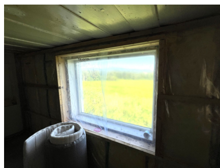
Stue 1. Etg: Uferdig og plast i front av vindu.
