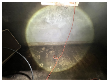
Nyere del av kjeller: Fukt .
