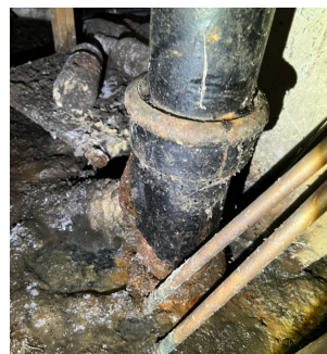
Soil hovedavløpsrør. Korrosjon
