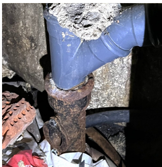
Stakeluke og rust (korrosjon) på soilrør i kjeller.
