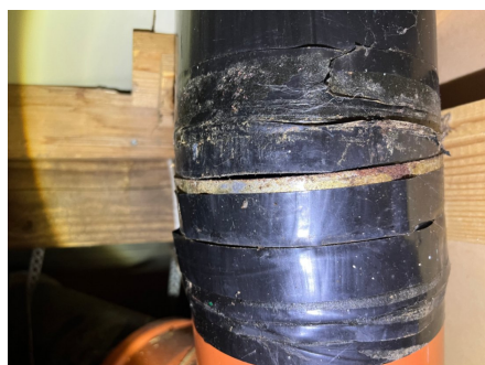
Utett rørskjøt på røret.
