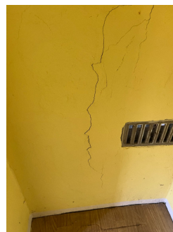
Soverom 1. Etg: Sprekker i brannmur mot stue.
