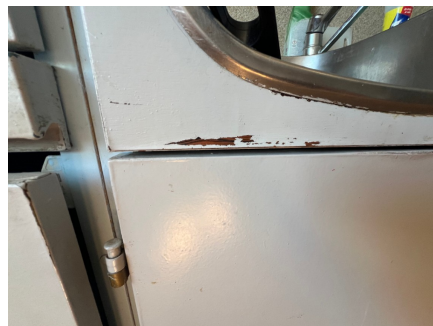
Skader/Merker i front.
