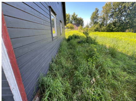
Nordside- Gavlvegg: Fall mot boligen.
