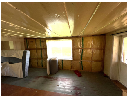
1. Etg: Stue. Skadet gulv, Uferdig utforet vegg.
