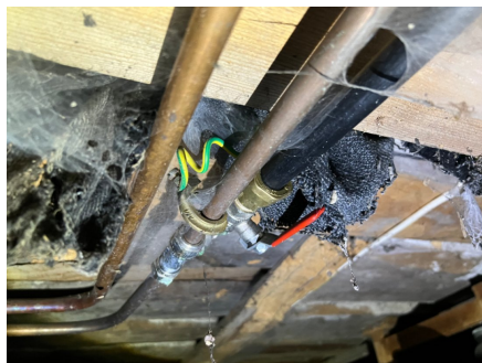
Rør i himling - kjeller.
