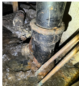
Soilrør med rust (korrosjon) i kjeller.
