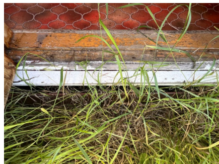
Vannbrett og dørterskel.
