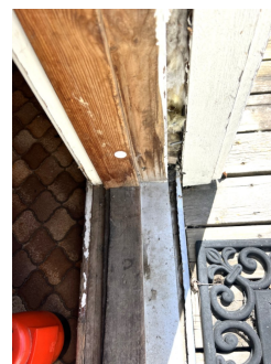
Utett mellom omramning og karm. Løst/utett beslag.
