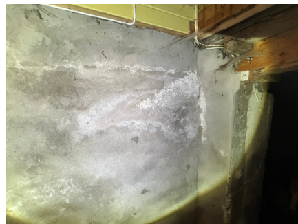
Nyere del av kjeller: Saltutslag på innervegg.
