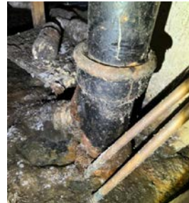
Soilrør med rust (korrosjon) i kjeller.
