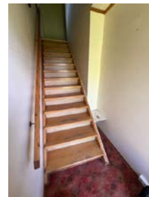
Ikke rekkverk i nedre del- høyre side.
