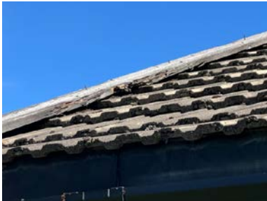
Råteskader i vindski- isbord- fremside- venstre side.
