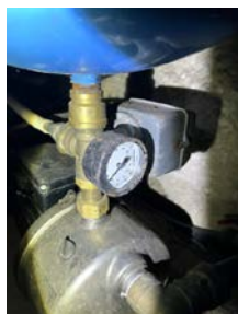
Overgang trykktank (blå) og vannpumpe under.
