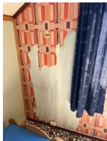
2. Etg: Soverom Skadet/løs tapet.
