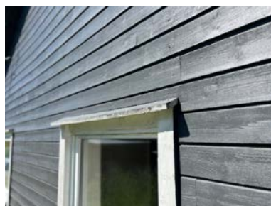
Vannbrett over vinduer uten beslag.
