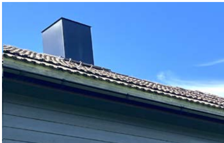
Bakside- Ikke forkantbeslag mellom tak/takrenne
