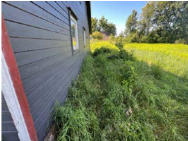
Nordside- Gavlvegg: Fall mot boligen.
