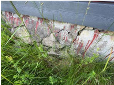
Utvendig: Sprekker i mur.
