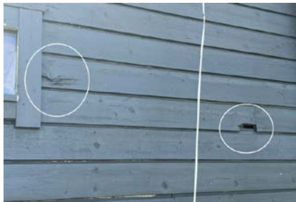
Råte og hull i kledning- (Innglasset terrasse)
