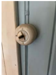
Kjøkken 2. Etg: Skadet lysbryter.
