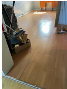
2. Etg: Kjøkkengulv. Nedskrudd laminatgulv.
