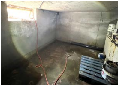
Nyere del av kjeller: Fukt og saltutslag.
