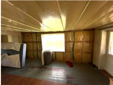
1. Etg: Stue. Skadet gulv, Uferdig utforet vegg.
