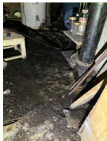
Soil hovedavløpsrør. Høyre for åpning til eldre kjeller.
