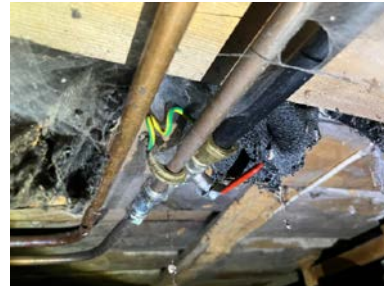
Rør i himling - kjeller.
