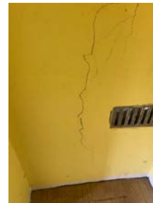
Soverom 1. Etg: Sprekker i brannmur mot stue.
