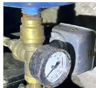
Korrosjon i overgang tank/pumpe. Noe korrosjon på vannpumpe.
