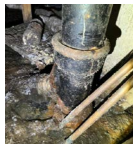
Soil hovedavløpsrør. Korrosjon
