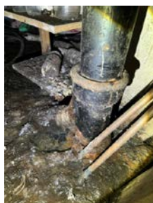
Soil hovedavløpsrør. Korrosjon
