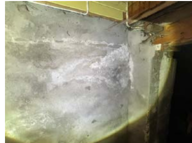
Nyere del av kjeller: Saltutslag på innervegg.
