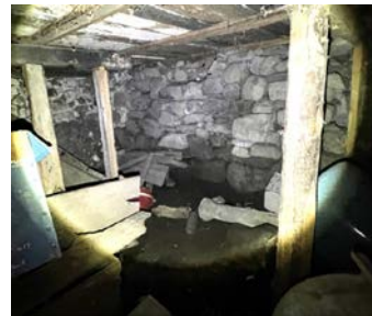
Eldre kjeller: Fukt på grunnen.
