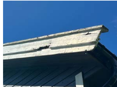
Råteskader i vindskier på baksiden- over innglasset terrasse.
