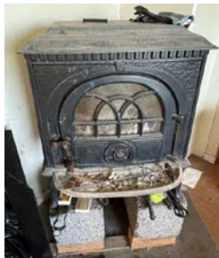
Peisovn 1. etg. Sprekk i bakkant innvendig.
