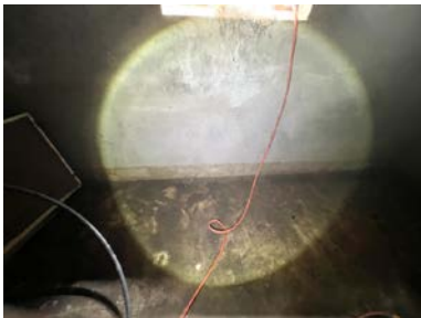
Nyere del av kjeller: Fukt .
