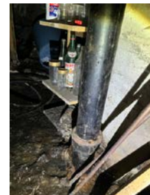
Soil hovedavløpsrør. Korrosjon. En del slam/vann/fukt.
