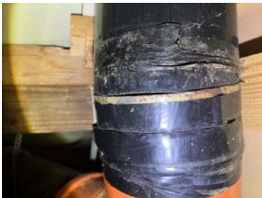
Utett rørskjøl på røret.
