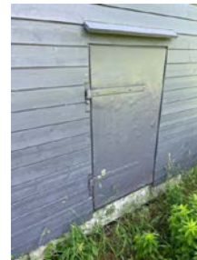
Dør i fasade- Gavlvegg nordside uten dør innvendig.
