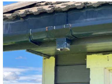
Takrenne uten nedløp.
