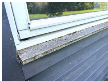
Vannbrett uten beslag og groing.
