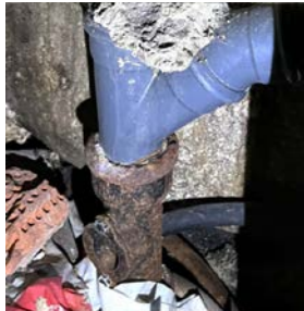
Stakeluke og rust (korrosjon) på soilrør i kjeller.
