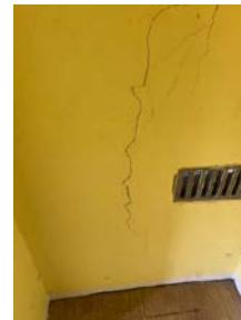
Soverom 1. Etg: Sprekker i brannmur mot stue.
