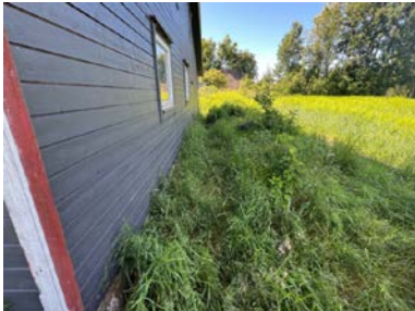
Nordside- Gavlvegg: Fall mot boligen.
