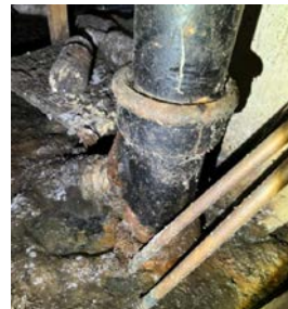
Soil hovedavløpsrør. Korrosjon
