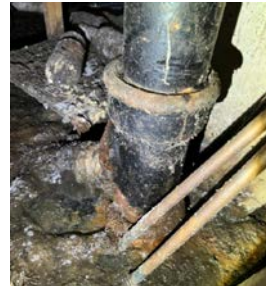
Soilrør med rust (korrosjon) i kjeller.
