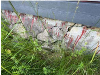
Utvendig: Sprekker i mur.
