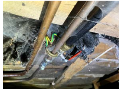
Rør i himling - kjeller.
