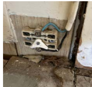
Stue 1. Etg: Defekt stikkontakt.
