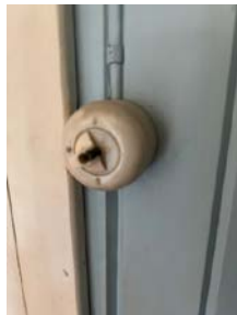
Kjøkken 2. Etg: Skadet lysbryter.
