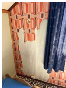
2. Etg: Soverom Skadet/løs tapet.
