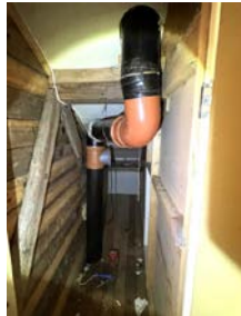
2. Etg: Radontiltak med vifte og rør ut til over tak.
