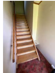
Ikke rekkverk i nedre del- høyre side.
