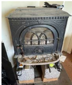
Peisovn 1. etg. Sprekk i bakkant innvendig.
