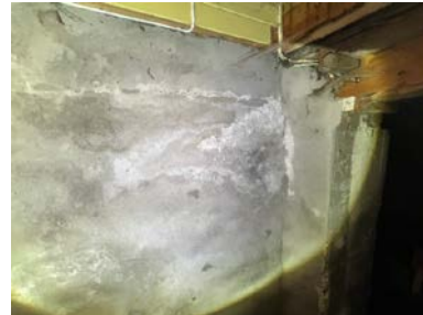
Nyere del av kjeller: Saltutslag på innervegg.
