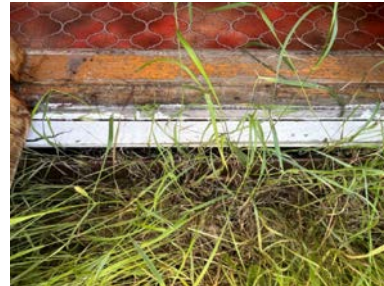
Vannbrett og dørterskel.
