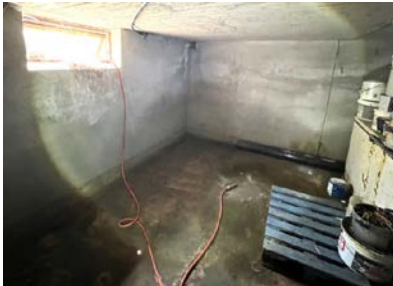
Nyere del av kjeller: Fukt og saltutslag.
