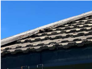
Råteskader i vindski- isbord- fremside- venstre side.
