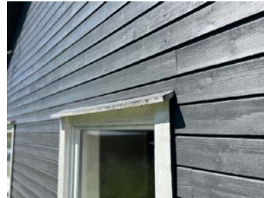
Vannbrett over vinduer uten beslag.
