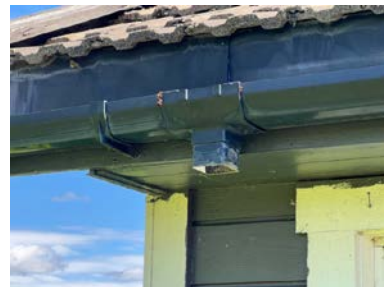
Takrenne uten nedløp.
