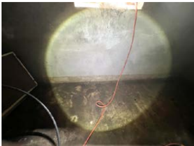
Nyere del av kjeller: Fukt .
