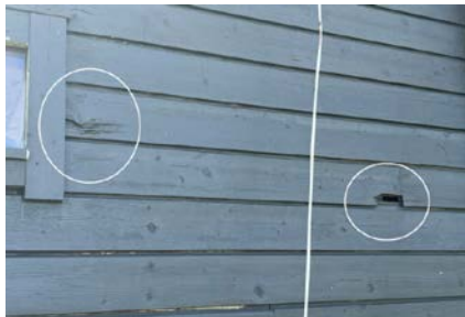
Råte og hull i kledning- (Innglasset terrasse)
