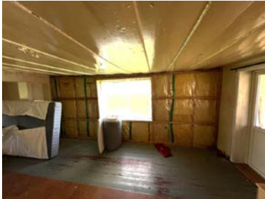
1. Etg: Stue. Skadet gulv, Uferdig utforet vegg.
