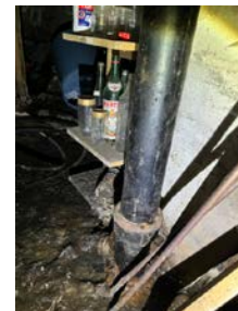
Soil hovedavløpsrør. Korrosjon. En del slam/vann/fukt.
