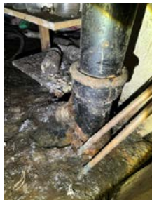
Soil hovedavløpsrør. Korrosjon
