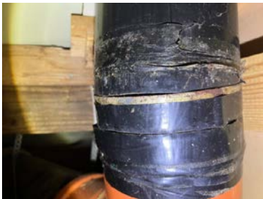
Utett rørskjøl på røret.
