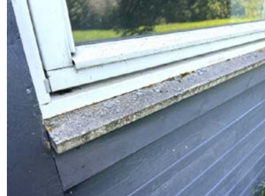
Vannbrett uten beslag og groing.
