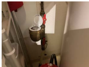
Stoppekran plassert på bod/teknisk rom.
