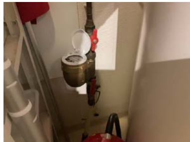
Stoppekran plassert på bod/teknisk rom.
