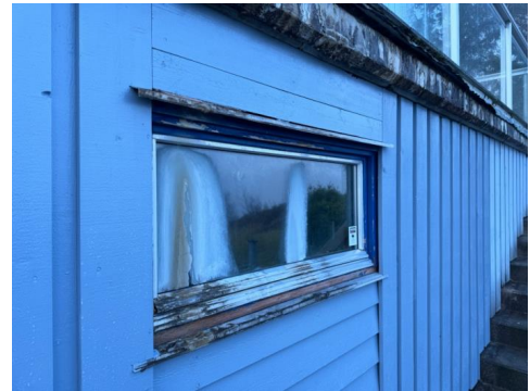
Vindu som må påregnes utskifting.
