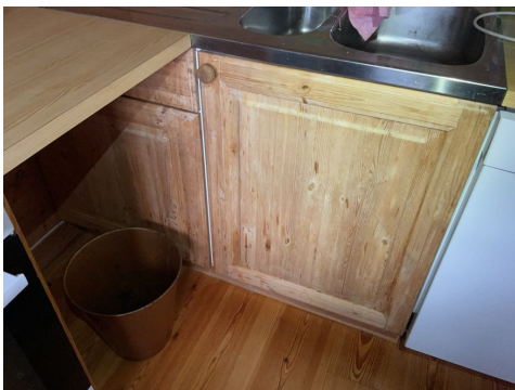
Slitasje på innredning
