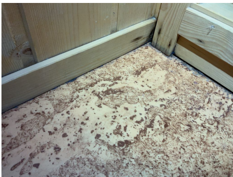
Ikke egnet konstruksjonsløsning
