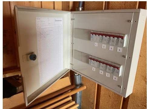
Sikringssskap i bod
