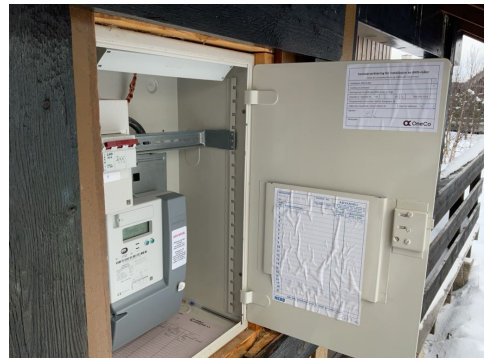
Utvendig skap med hovedsikring og fjernavleser
