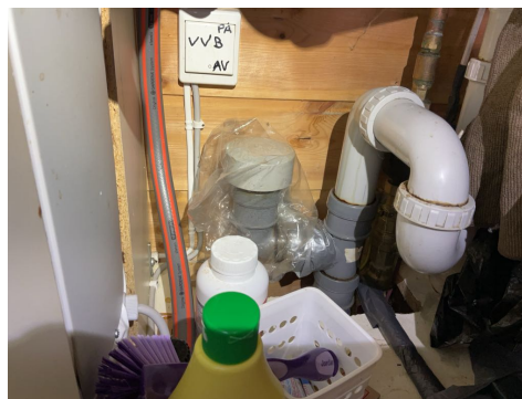
Utilfredsstillende lufteløsning, ved tiltak bør føres over tak.
