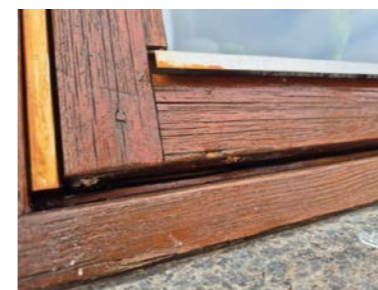
Sprekker i treverk.
