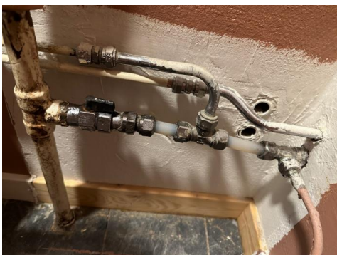
Eldre malte kobberør på wc.
