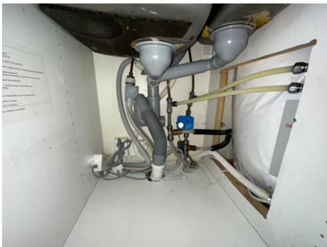
Røropplegg i kjøkkenbenk med Waterguard
