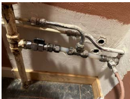
Eldre malte kobberrør på wc.
