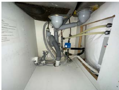
Røropplegg i kjøkkenbenk med Waterguard
