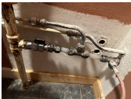
Eldre malte kobberør på wc.
