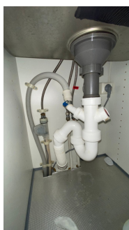
Røropplegg under kjøkkenbenk i underetasje
