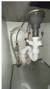
Røropplegg under kjøkkenbenk i underetasje
