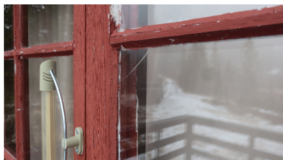
Sprekk i rute.
