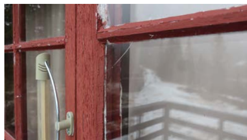
Sprekk i rute.
