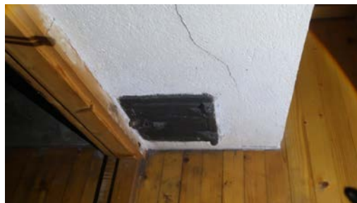
Feieluke for nær treverk. Mangler plate på gulv under luken.
