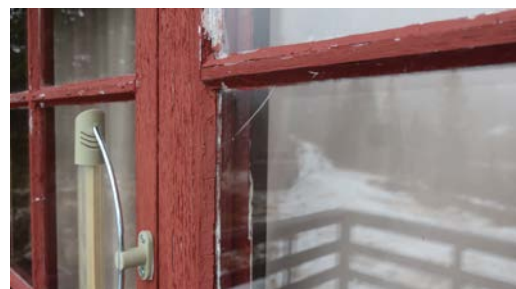
Sprekk i rute.
