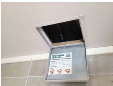
Stoppekran plassert i himling på bad.
