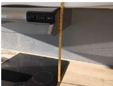
Lav høyde på avtrekksvifte (43 cm).
