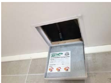
Stoppekran plassert i himling på bad.
