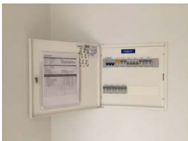
Sikringsskap plassert i gang.
