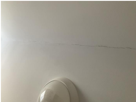
Sprekk i himling på loft.
