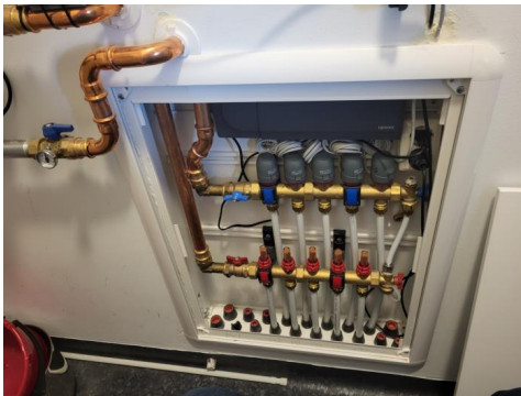
Fordelingskap for vannbåren varme i gulv.
