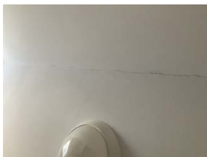
Sprekk i himling på loft.
