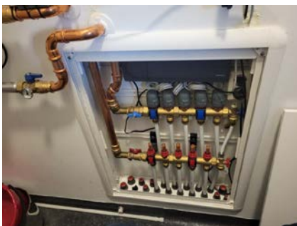
Fordelings-skap for vannbåren varme i gulv.
