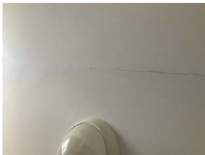
Sprekk i himling på loft.
