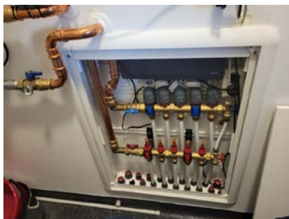
Fordelings-skap for vannbåren varme i gulv.
