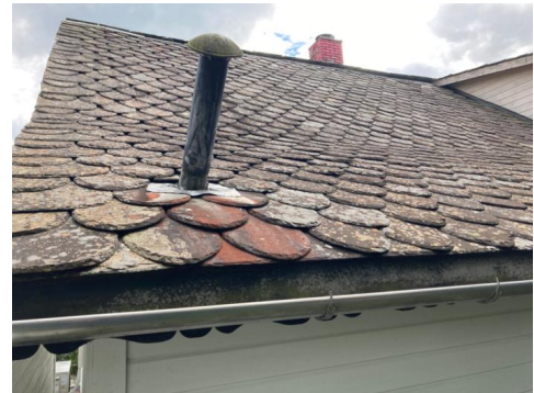
Skade i lufteventil fra bad
