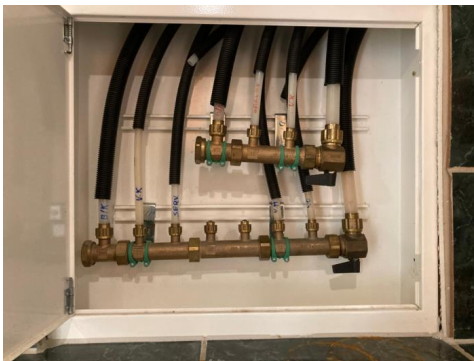
Mangler drenering fra skap på vaskerom
