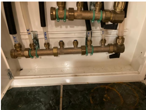
Fordelerskap for rør i rør, montert på vaskerom
