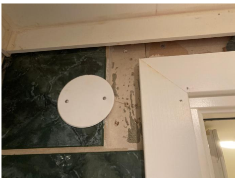
Mangler flis på vegg
