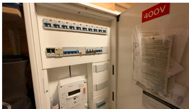
Skap er plassert i bod ved entre.
