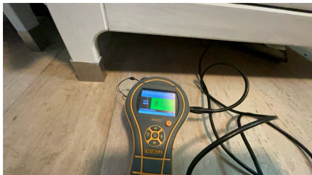
Bilde viser fuktmåling utført i trevirke tømmervegg bak servantskap.
