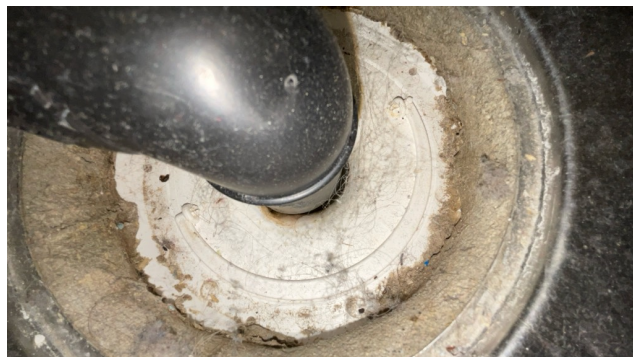
Bilde viser sluk under dusjkabinett. Dusjkabinett er ikke fjernet/flyttet.
