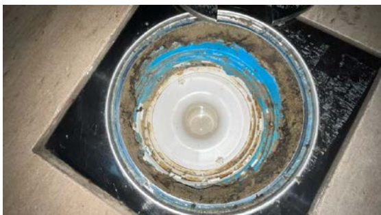
Bilde viser sluk under tidligere dusjkabinett.
