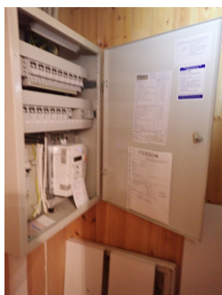
Sikringsskap med automatsikringer.
