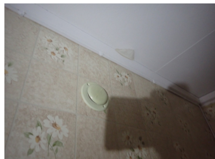
Eldre fuktmerker i innvendig tak
