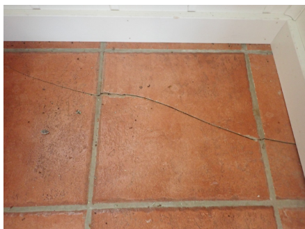
Skader / sprekker i gulvflis.
