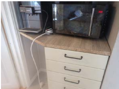
Ingen folie i endaved på benkeplate / dårlig innfesting.
