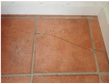
Skader / sprekker i gulvflis.
