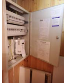
Sikringsskap med automatsikringer.
