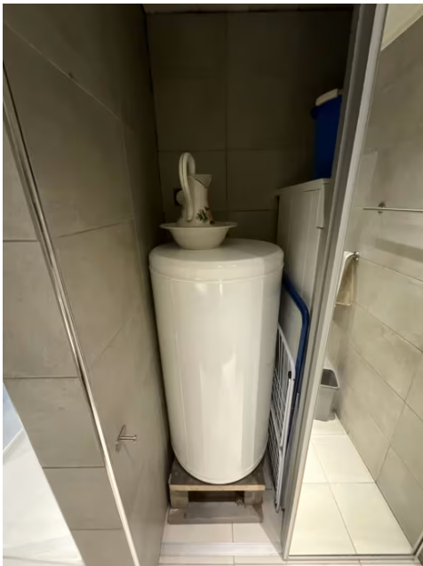
Viser bereder plassert bak skyvedører på bad.
