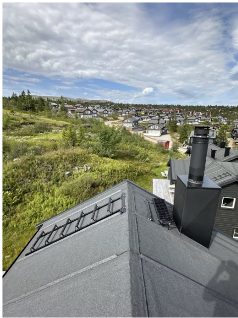
Viser fastmontert stige, feieplattform og pipebeslag.
