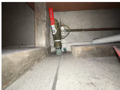
Viser hovedstoppekran plassert på bad.
