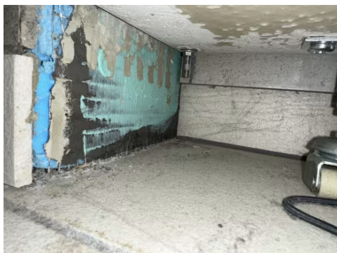
Viser utettheter/manglende arbeid under dusjkabinett.
