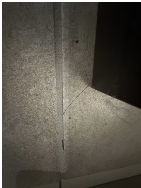
Viser sprekke i veggflis ved innredning.
