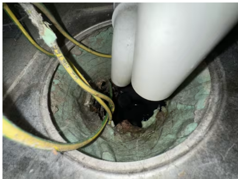
Viser løsningen rundt sluk. Det registreres ikke klemring. Ytterligere undersøkelser anbefales.
