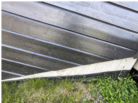
Det registreres knotteplast med topplast ved synlige grunnmurer.
