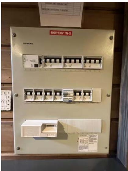
Viser innfelt sikringsskap i gang 1.etasje med sikringer og jordfeilbrytere.
