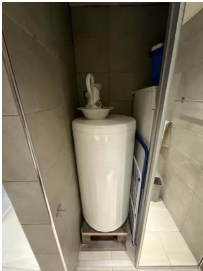
Viser bereder plassert bak skyvedører på bad.
