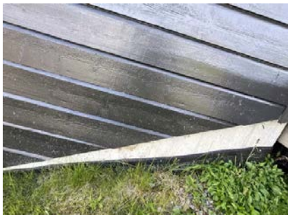
Det registreres knotteplast med topplis ved synlige grunnmurer.
