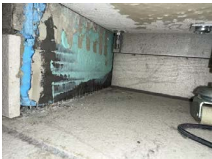
Viser utettheter/manglende arbeid under dusjkabinett.
