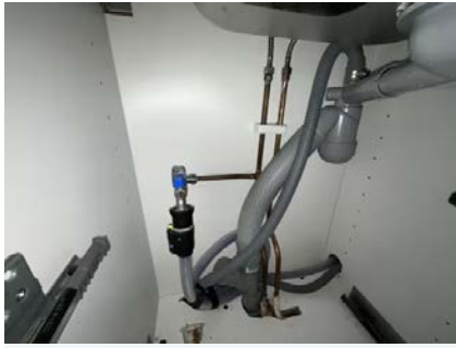
Viser vann og avløpsinstallasjoner under kum.
