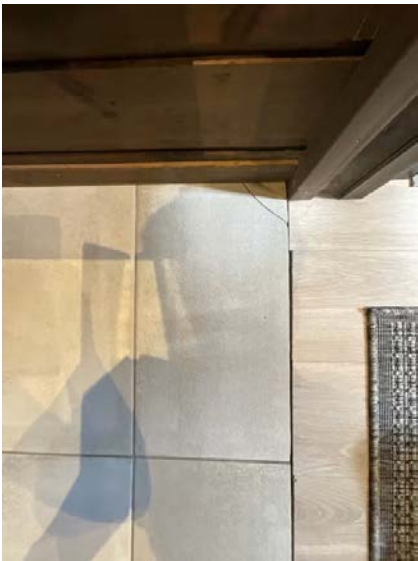
Det registreres sprekk i flis ved inngangsparti.
