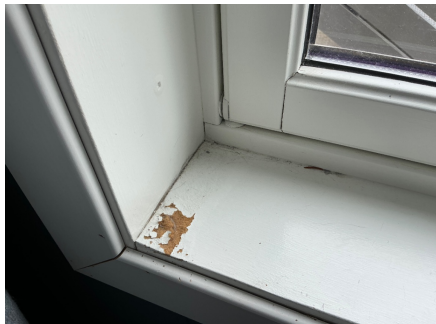
Skade på vinduskarm i soverom.
